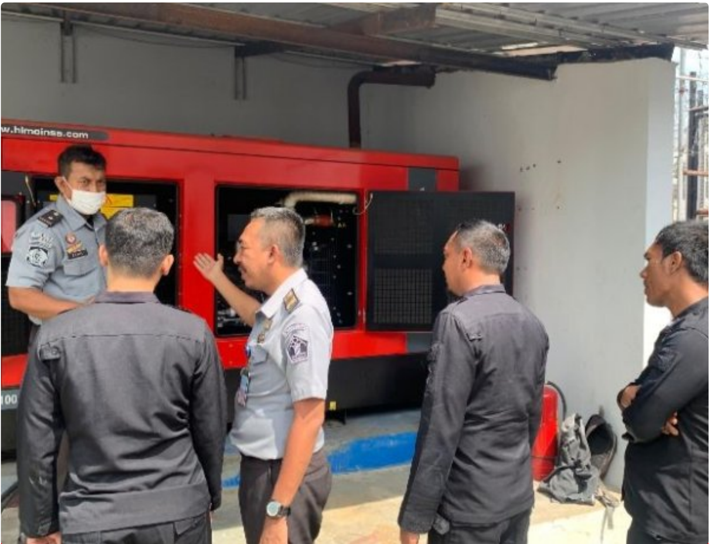
Deteksi Dini Gangguan Kamtib, Lapas Purwokerto beri Simulasi Pengoperasian Genset Kepada Regu Pengamanan
